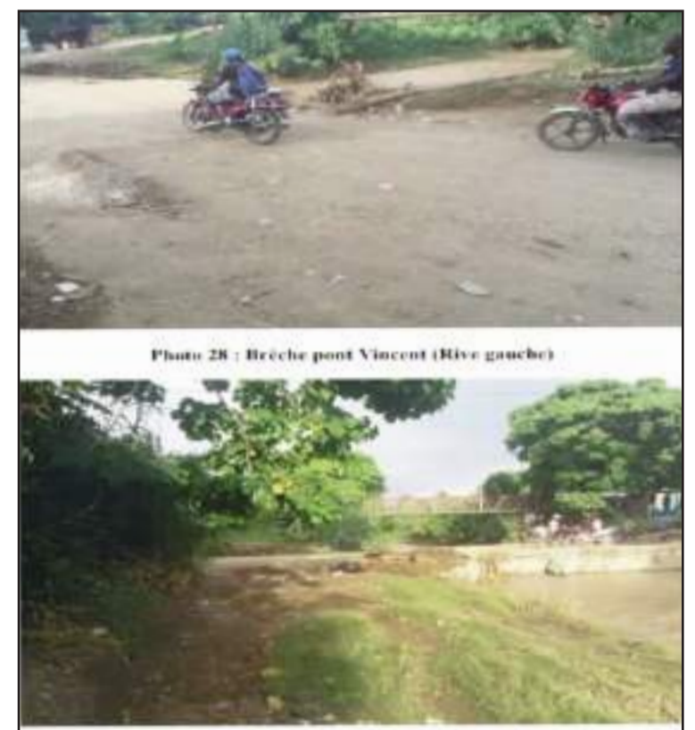
Brèche de la rive droite du Pont Vincent.
