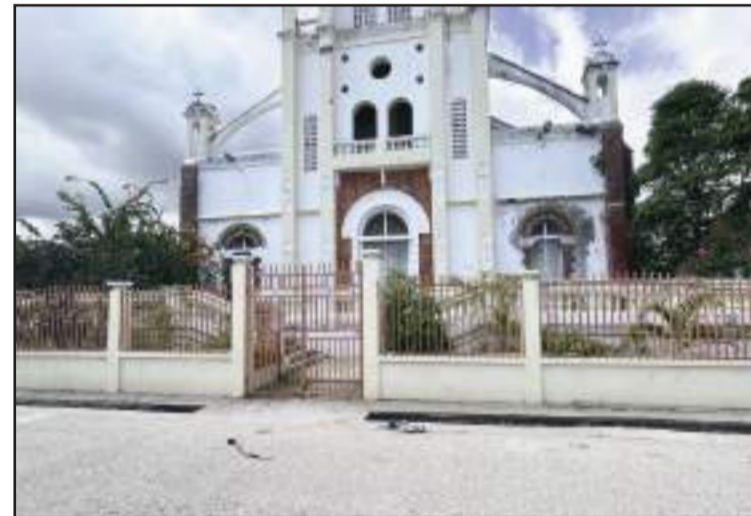
L'église catholique d'Aquin, fissurée lors du tremblement dévastateur de janvier 2010, inutilisable.
